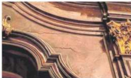
IL DOLORE Lo scorso autunno durante uno dei tanti sopralluoghi nella Farmacia per verificare le crepe nel pavimento l'ingegnere Esposito notò spaccature anche nelle scaffature di legno
