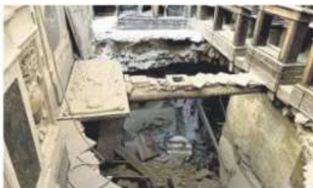
I DANNI Il 24 marzo scorso un crollo all'interno della chiesa di Santa Maria del Popolo che si trova all'interno dell'ospedale. Non sono ancora note le cause del cedimento
