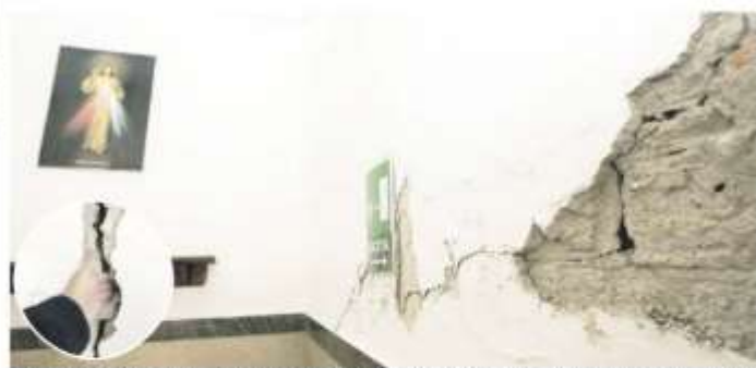
COMPITI Una grossa crepe sul muro. Nel riquadro la mano dell'ingegnere Edoardo Cosenza in una fessura nella parete
