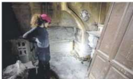
LA TOMBA Lo scorso ottobre una verifica nella chiesa rivelò la spaccatura di una fogna che riversava liquami direttamente sopra la tomba antica di un sacerdote
