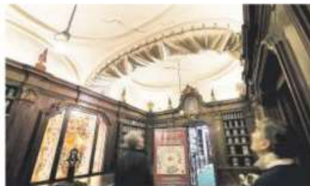
I CONTROLLI Ieri un sopralluogo all'interno della Farmacia conferma l'ampliamento delle crepe. Anche per quel luogo che era considerato ancora sicuro scatta l'allarme
