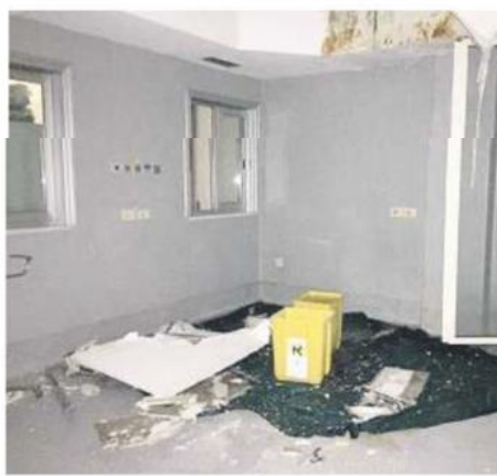
L'ULTIMO ALLARME Il controsoffitto crollato
